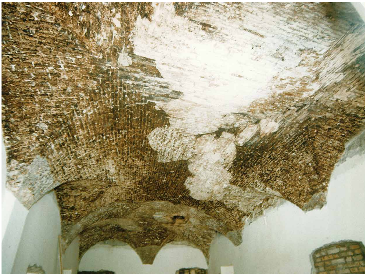
Volte deteriorate prima del restauro
